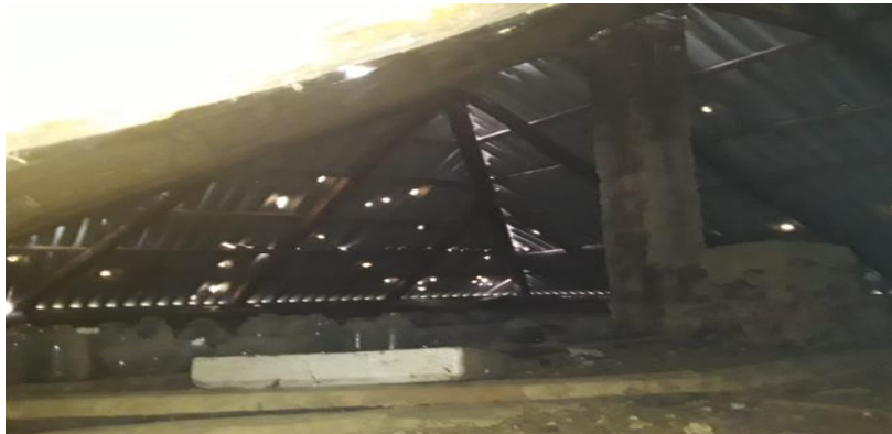
Рисунок 3.4.6 – Повреждение крыши частного домовладения в п. Псебай 25 июня 2021 г.
