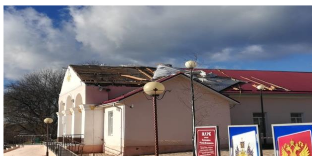
Рисунок 3.4.8 – Повреждение крыши социально-значимого объекта в г. Новокубанск 1 декабря 2021 г.
