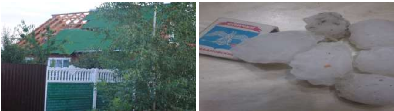
Рисунок 3.4.4 - Повреждения зданий, отключение электроснабжения в Краснодарском крае (Калининский район) в результате комплекса метеорологических явлений
